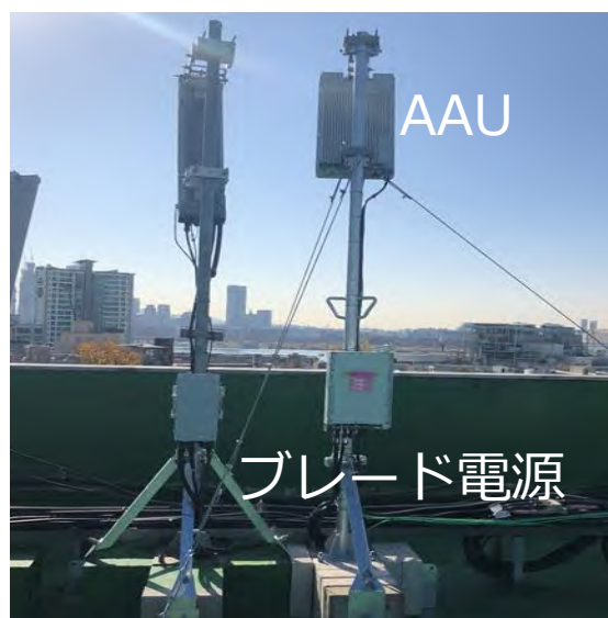
小型ブレード電源
